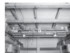
■ 天井クレーン
